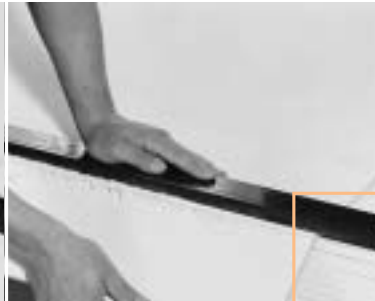
Figure 13 : Rompage de la plaque sur la ligne de rupture
