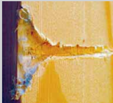
Déformation plastique dans des montants en bois (résistance à la pression latérale faible)
