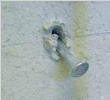
Élargissement du trou dans la plaque FERMACELL (haute résistance à la pression latérale)
